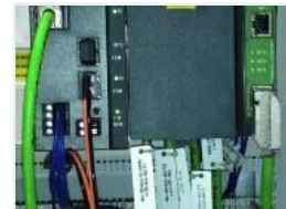
TH Link Profinet liefert auch bei wenig Platz im Schaltschrank detaillierte Information über die eingesetzten Geräte. (Bild: Audi)
